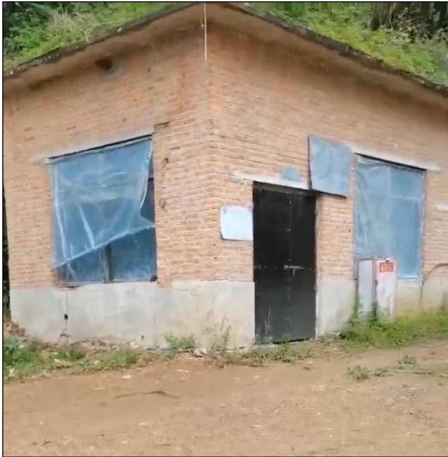
照片 1-4 地窰子区段空压机房
